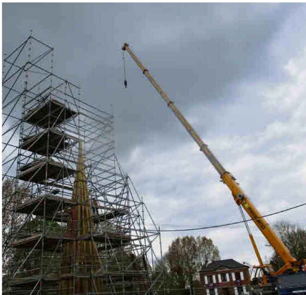
Le clocher, rebâti, a été provisoirement déposé sur un échafaudage (Photo Paris-Normandie)
