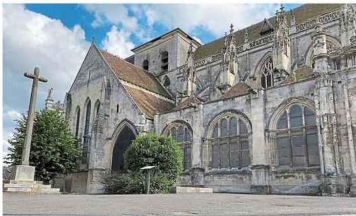
Avec l'usure des siècles et les bombardements de 1944, l'église Sainte-Trinité a beaucoup souffert et a besoin d'être rénovée.
