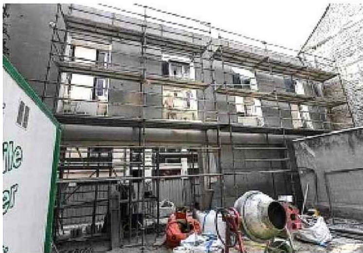
La façade en pierre repose sur un mur en béton. Hervé Oudin
