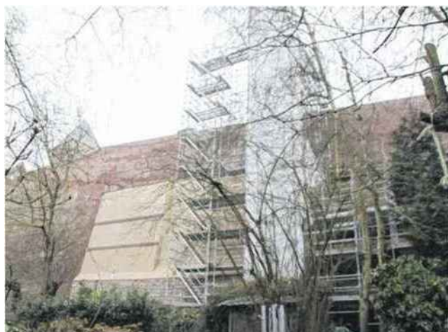
Les échafaudages ont dû être installés sur le terrain de plusieurs riverains. On peut voir également la partie qui a connu un effondrement à l'hiver 2019.
