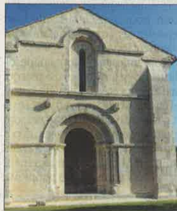
À l'extérieur, les murs ont été assainis après avoir été débarrassés de leurs joints en ciment. PHOTO DELPHINE LAMY
