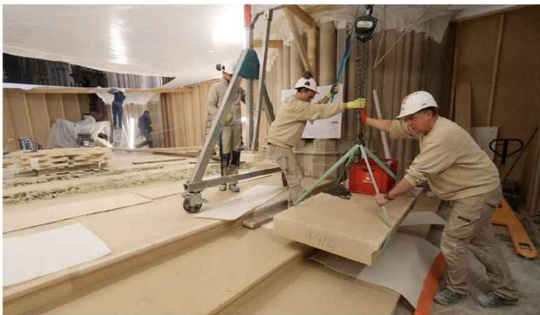
Les dernières marches du nouveau chœur sont installées, tandis que les premières dalles en pierre qui recouvrent le sol sont posées.
